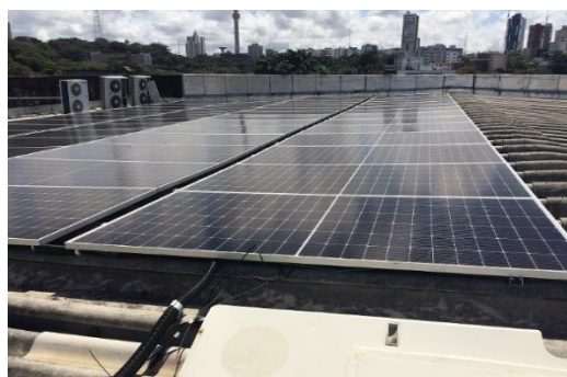
Placas fotovoltaicas e inversores fotovoltaicos instalados no PAF V
